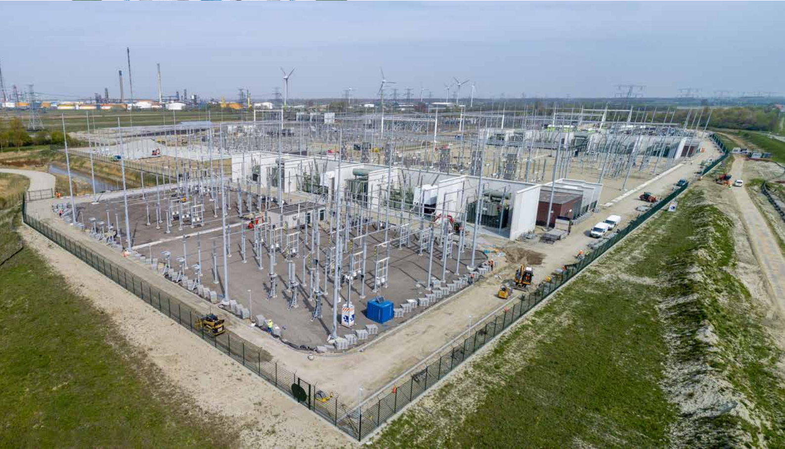
Voorbeeld transformatorstation voor windparks aansluiting Borssele (in aanleg, circa 7 hectare groot)
